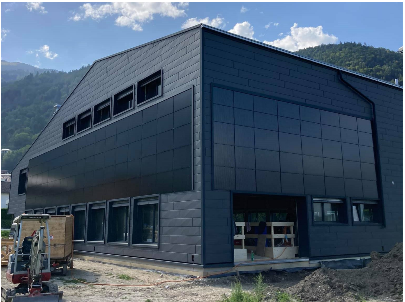
Sul tetto e sulle facciate della nuova palestra sportiva e di lotta svizzera Rüfeli a Untervaz è installato un impianto fotovoltaico di Repower.
