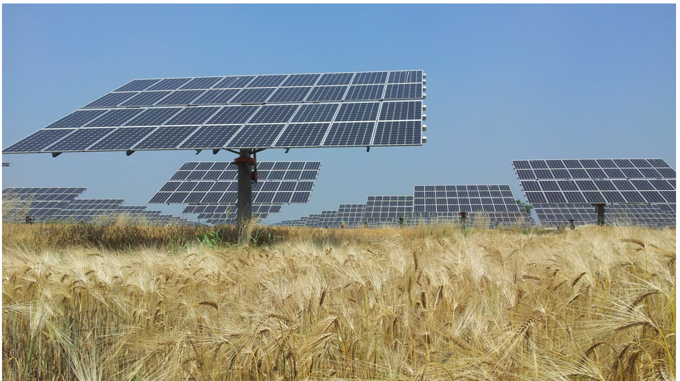
Impianto fotovoltaico bifacciale a Castelgugliermo.
