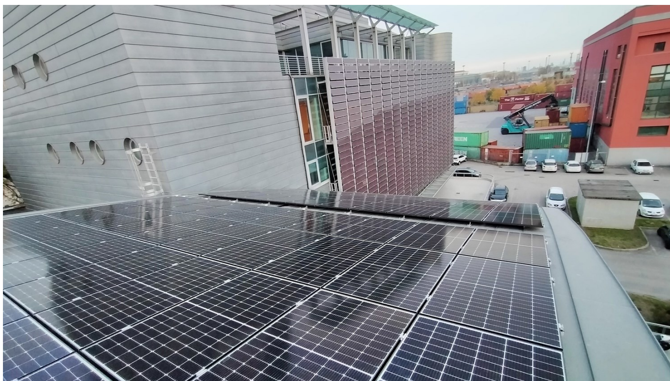
Un impianto solare da 70 kWp di ERRECI presso il porto di Marghera, vicino a Venezia.
